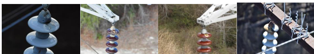
Hình 2. Chuỗi sứ cách điện bị sét đánh.
